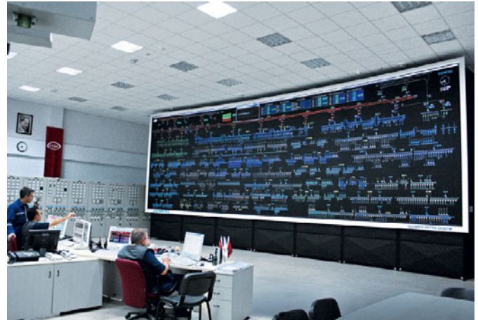
Figura 7.2-2: Pared de pantalla grande para operación en red en un gran centro de control
